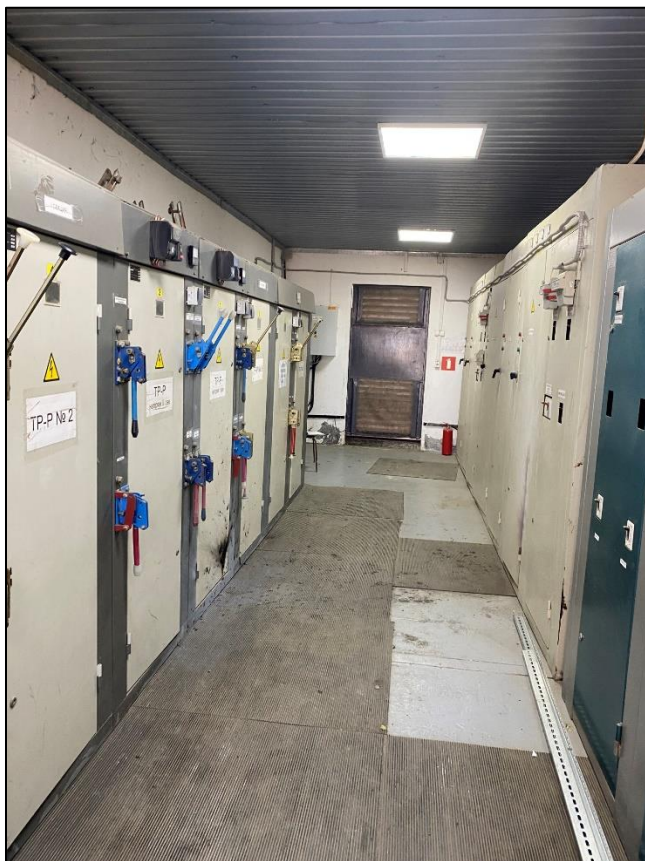
ТП (ЗРУ 6/0,4 кВ)
