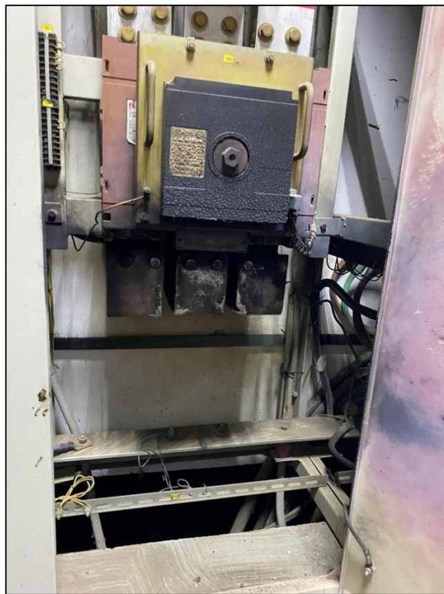
Шкаф 0,4 кВ № 2 «Перекресток ввод № 2»
